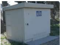
Poste PSSA (autres postes)
