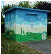
Poste cabine basse
