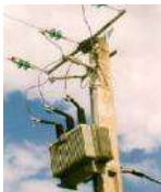
Poste sur poteau « H61 »
